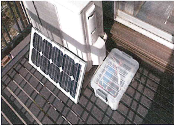
ベランダにシステム一式を設置 （Sさん宅 20W）
